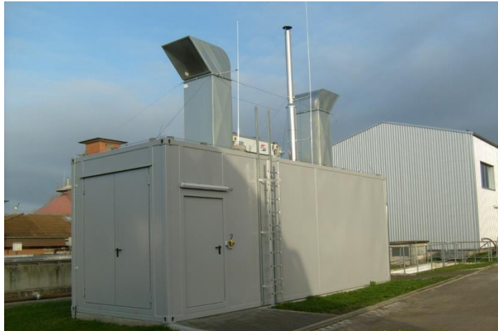
Blockheizkraftwerk auf der Kläranlage Heppenheim
